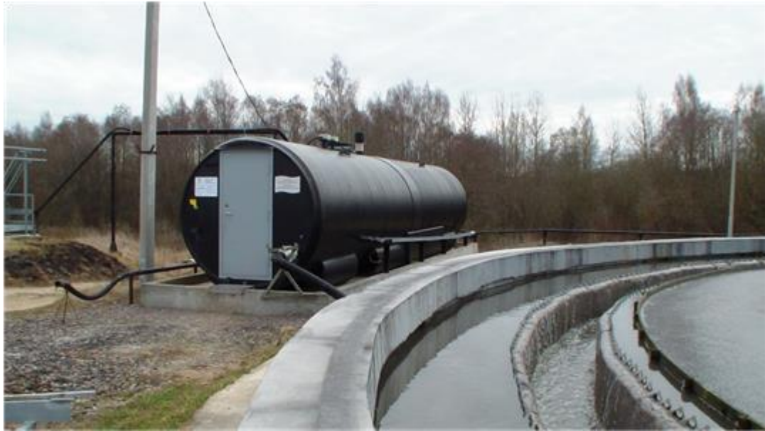
Рисунок 43 - Станция дозирования химреагентов
