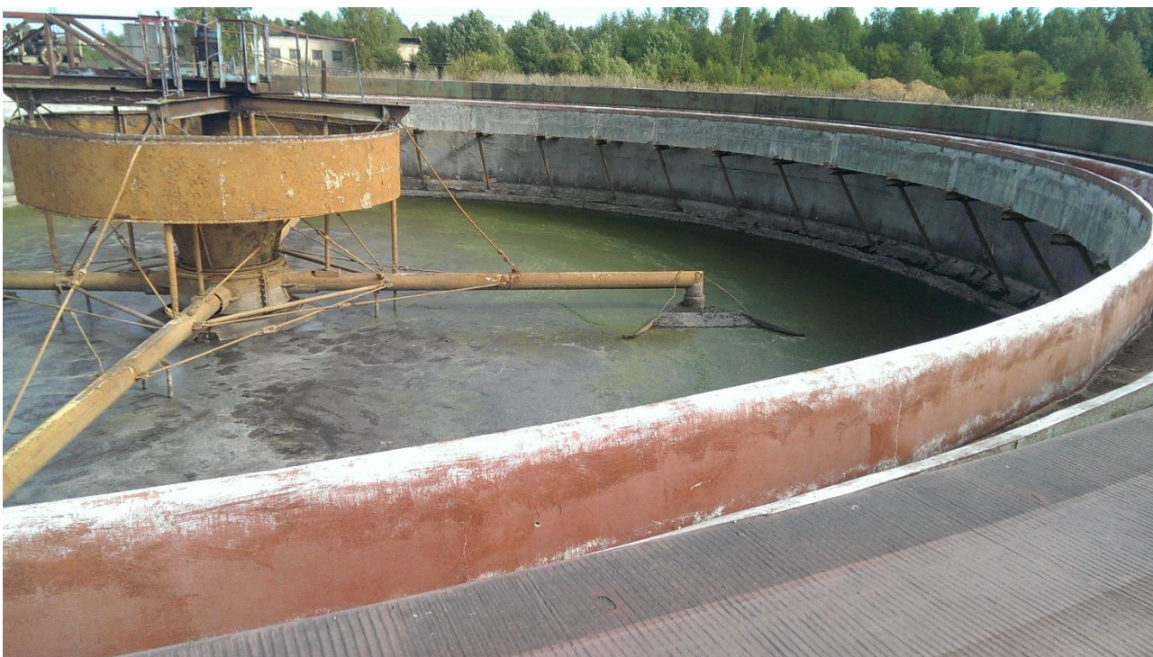
Рисунок 60 - Вторичный отстойник (опорожненный)
