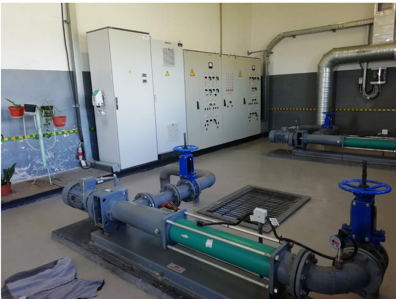
Рисунок 44 - Насосная станция сырого осадка
