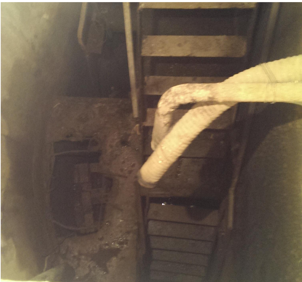
Рисунок 69 - Резервуар КНС ул.Чехова д.21
