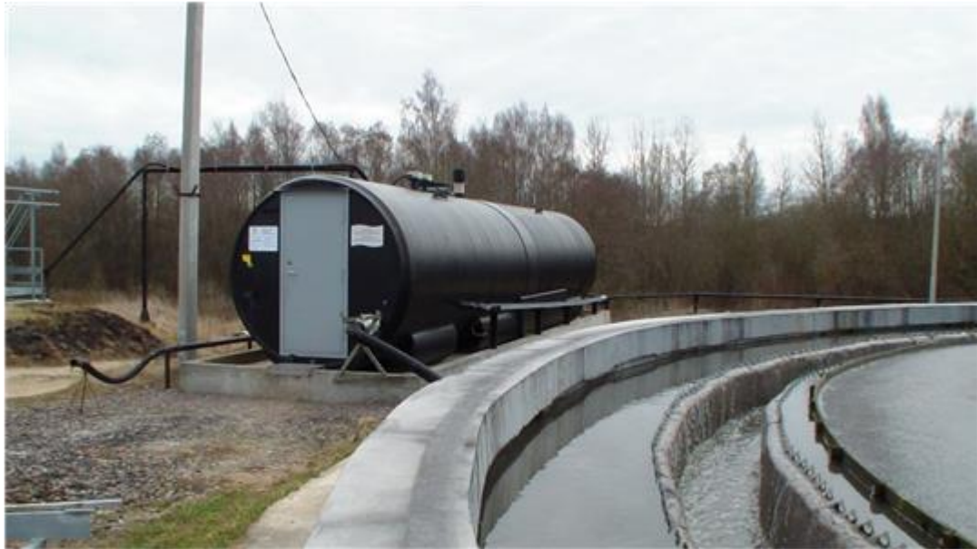
Рисунок 54 - Станция дозирования химреагентов
