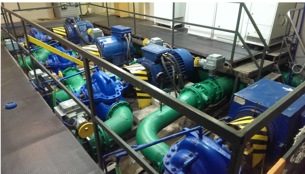
Рисунок 12 - Машзал насосной станции водозабора оз. «Серебряное»
